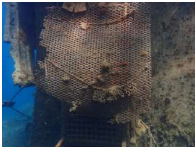
Imagen 8: Unidad 10005 con el cuarto inferior caído.
