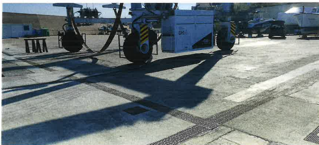
Imatge canaletes de recollida de aigües de pluja i treball al escar
