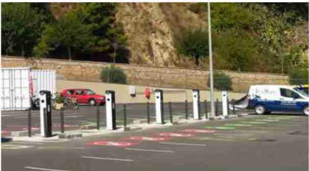
Aparcament Ponent. Punt de càrrega de vehicles elèctrics.
