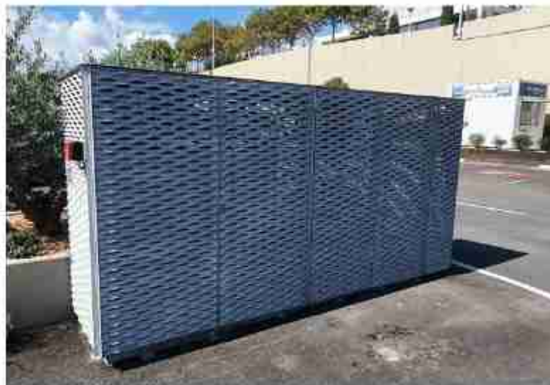
Punt d'extinció amb mànegues i escumogen.. Vista exterior.
