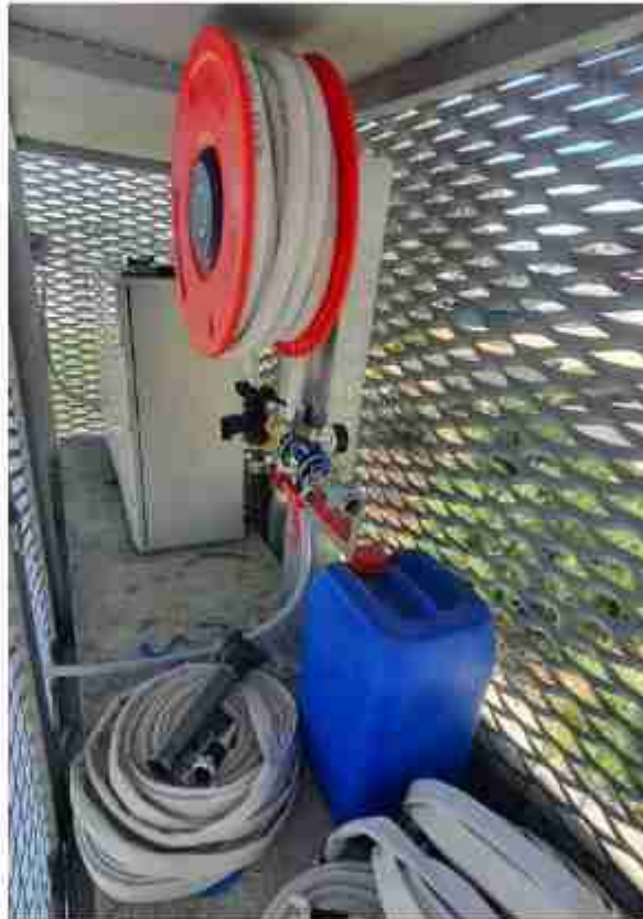
Punt d'extinció amb mànegues i escumogen. Vista interior.
